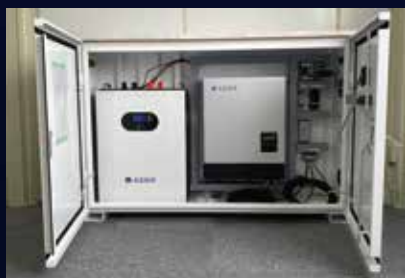
電源ユニット
